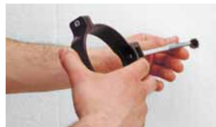
Рис.22 Закрепление водосточной трубы в хомуте
